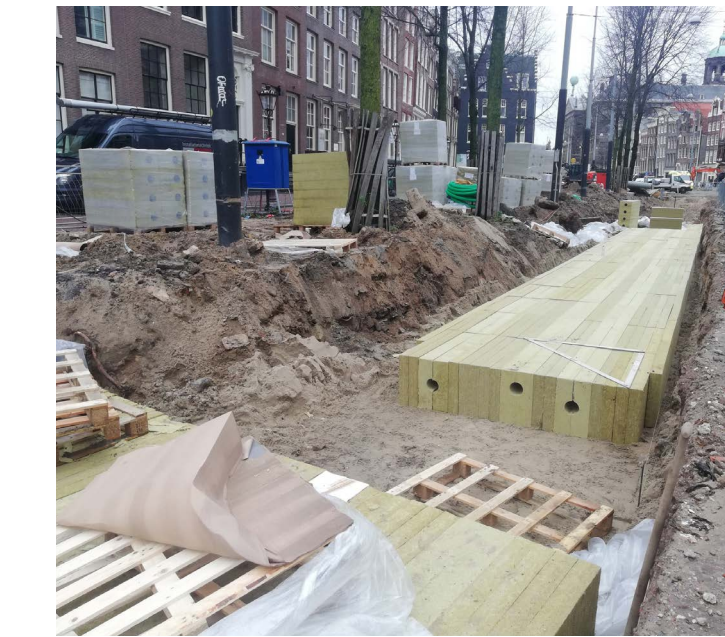
Infiltratieblokken Nieuwezijds Voorburgwal Deze oplossing heeft een grotere opslagcapaciteit en neemt geen ruimte bovengronds
